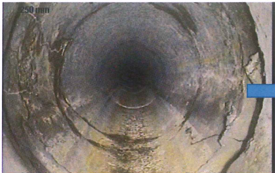
Abbildung 1: Kanalisationsleitung mit Schaden
